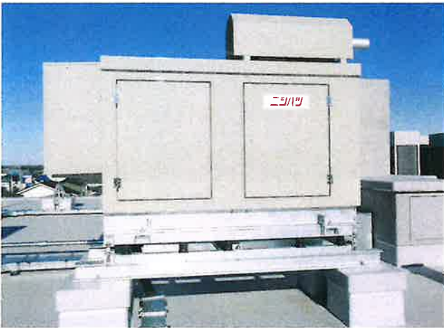
低騒音型 100KVA (非常用発電機)
