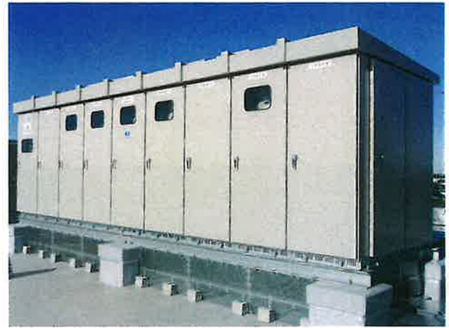
屋上設置 8面体 (キュービクル)
