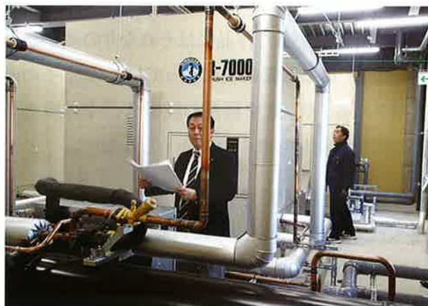
↑冷凍設備廻り クラッシュド、コンプレッサーユニット×4、アイスメーカー(700Type)×4
