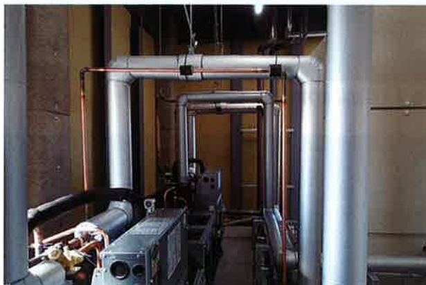
↑コンプレッサー(チラー)ユニット(2台) (6.6TON/d×4)
