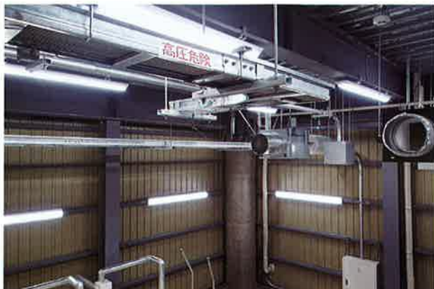
↑機械室内 照明設備、幹線ケーブル、換気設備
