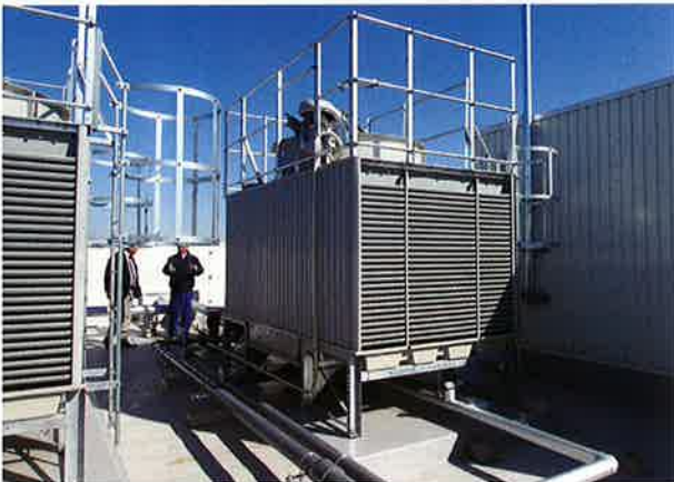
↑ 屋上クーリングタワー廻り(60RT×2 基)
