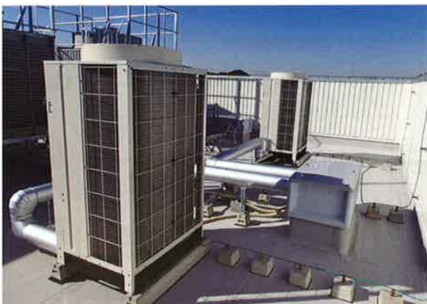
↑ 機械室用パッケージ AC 室外機(重耐塩仕様)
