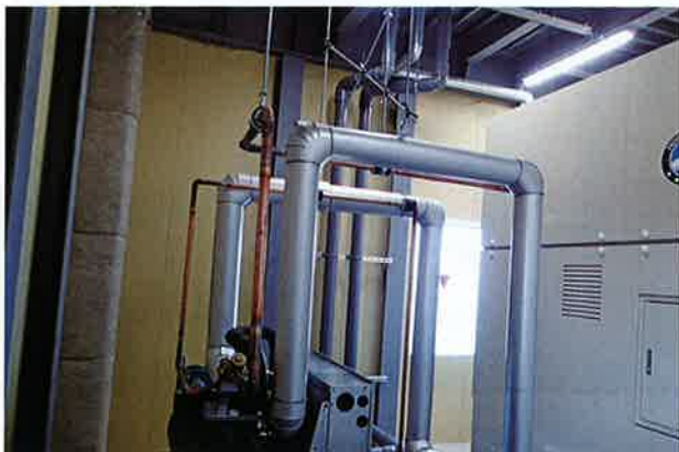
↑製氷機とクラッシュドアイス、コンプレッサー(チラー)ユニット廻り
