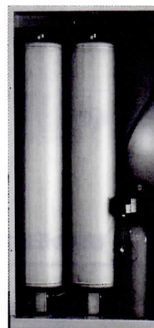
消火薬剤ユニット
