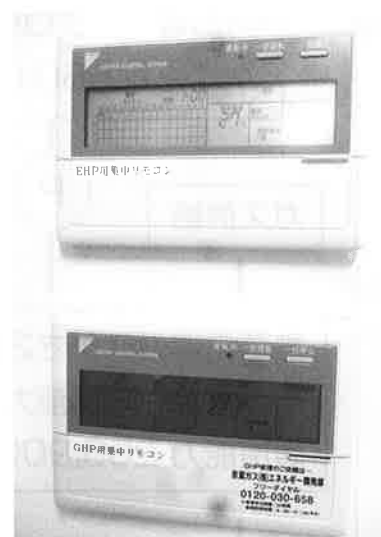
新設 集中リモコン
