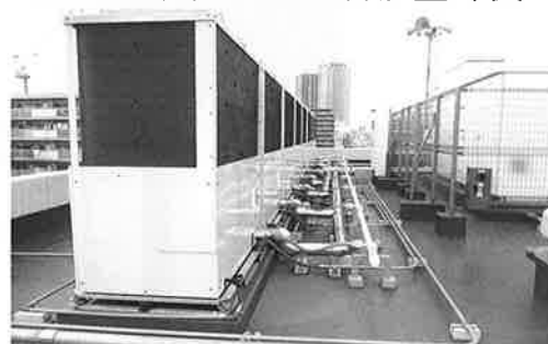
屋上に設置された新設室外機
